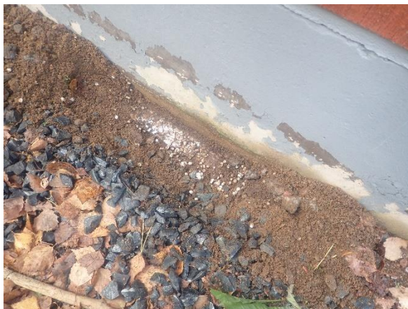
Kuva 4 Laajennusosalla sokkelia vasten on EPS eriste. Maalin hilseily viittaa sokkelin kosteusrasitukseen.
