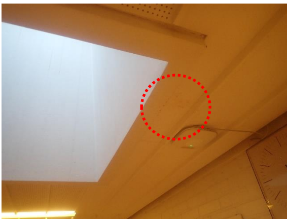
Kuva 78 Aulatilassa 201 kattoikkunan reunalla yksittäiset, vanhat kuivuneet kosteusjäljet.
