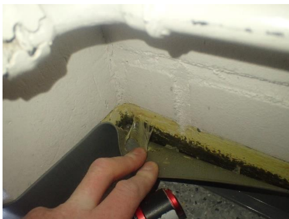
Kuva 41 Laajennusosalla ala-/välipohjan ja ulko- seinän liittymässä havaittavissa vanhoja tiivistyksiä.
