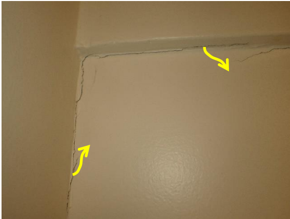
Kuva 13 Pukuhuonetila 008, lähikuva, ilmavuotoa tiilimuurauksen reuna-alueilta.
