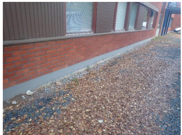
Kuva 5 Maanpinnan kaadot ovat osittain virheellisesti rakennusta kohden.
