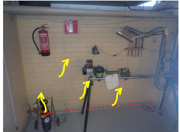
Kuva 14 Tekninen työ 020, ilmavuotoa maanvastaisen seinän eristetilasta alapohjan liittymästä ja tiilimuurauksen saumoista.
