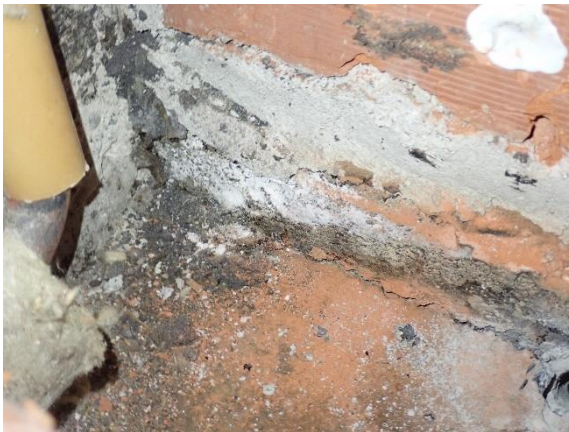
Kuva 5 Tiilimuurauksen alareunassa kalkkihär- mää, ja pintakosteusarvot ovat koholla.
