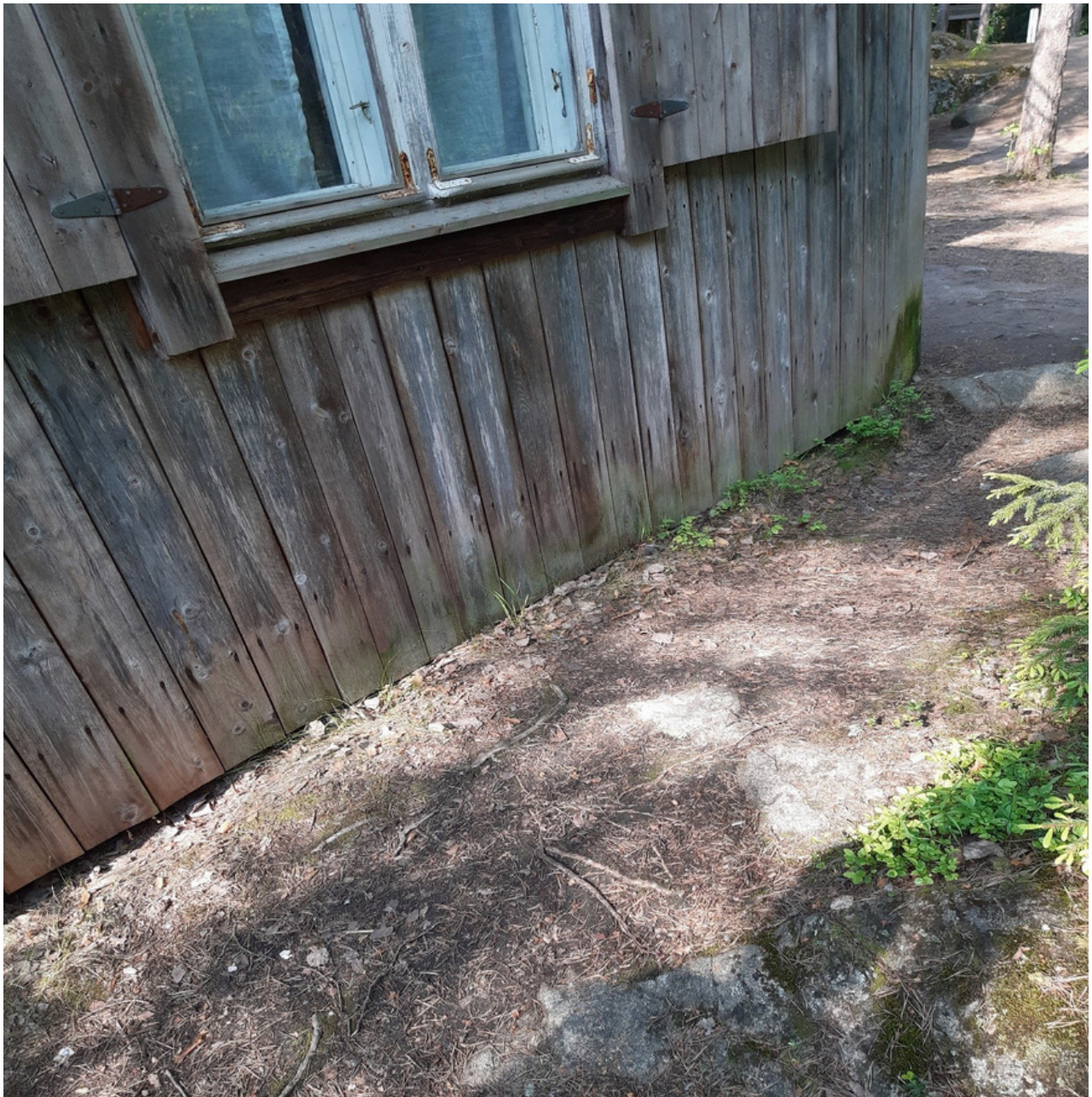
Julkisivun laudoitus on kosketuksessa maahan ja alkaa mädäntymään.
