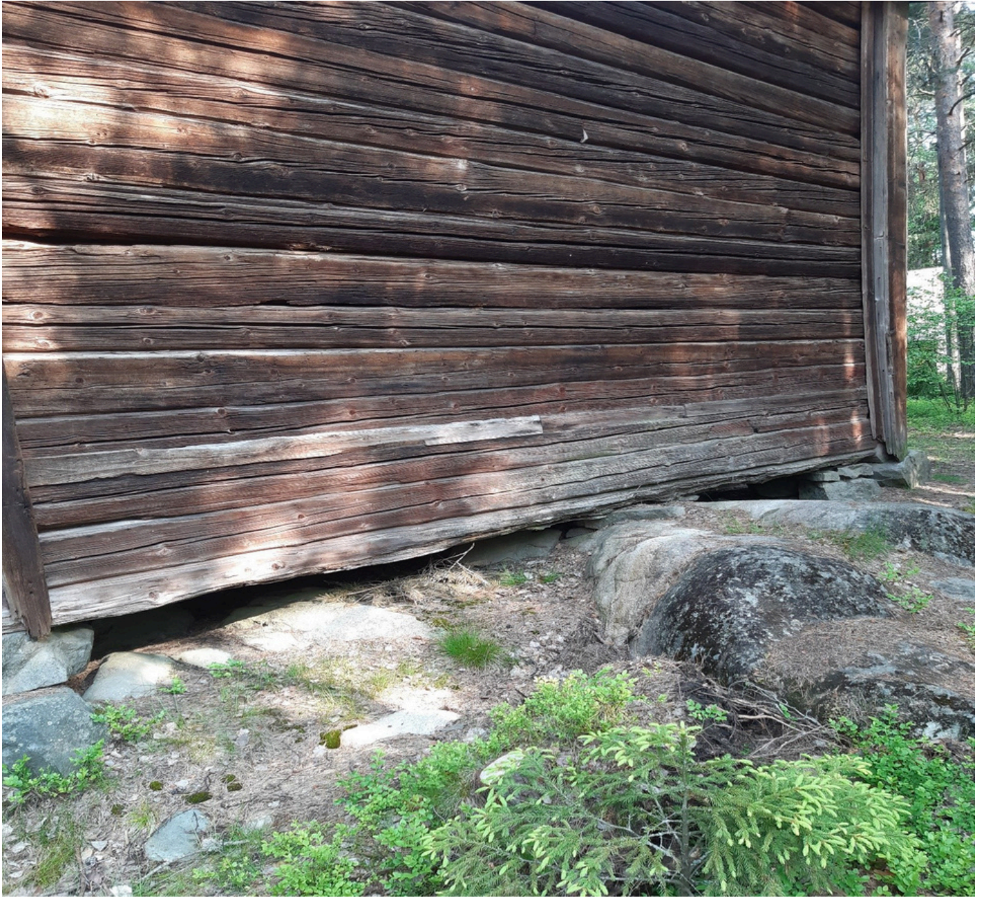
Alahirren vaihto. On päässyt kosteuden kanssa tekemisiin ja on todella huonossa kunnossa.
