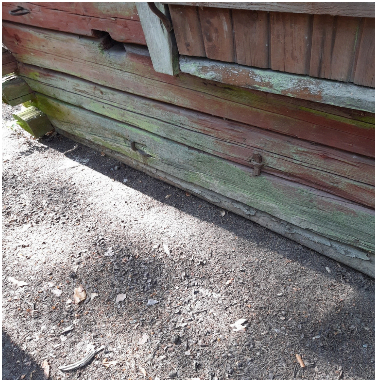
Rakennuksen alahirsi maata vasten. Pitäisi kaivaa auki ettei ala lahoamaan lisää.
