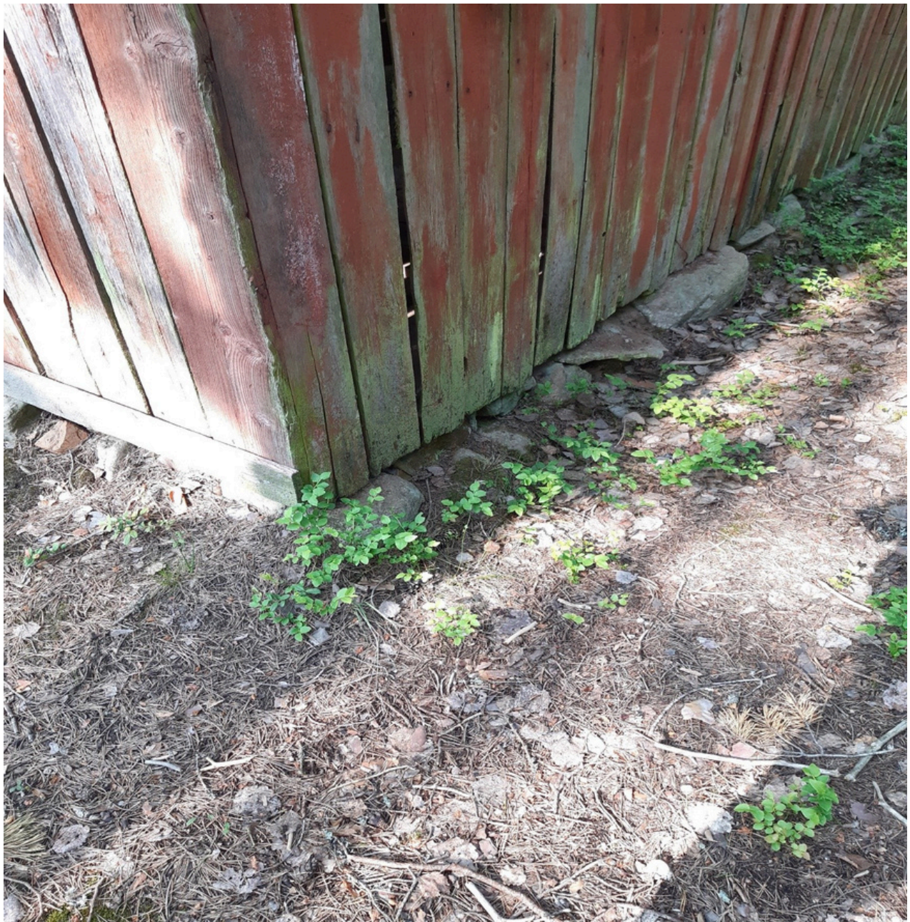
Julkisivun laudoitus on kosketuksessa maahan ja alkaa mädäntymään kosteudesta.
