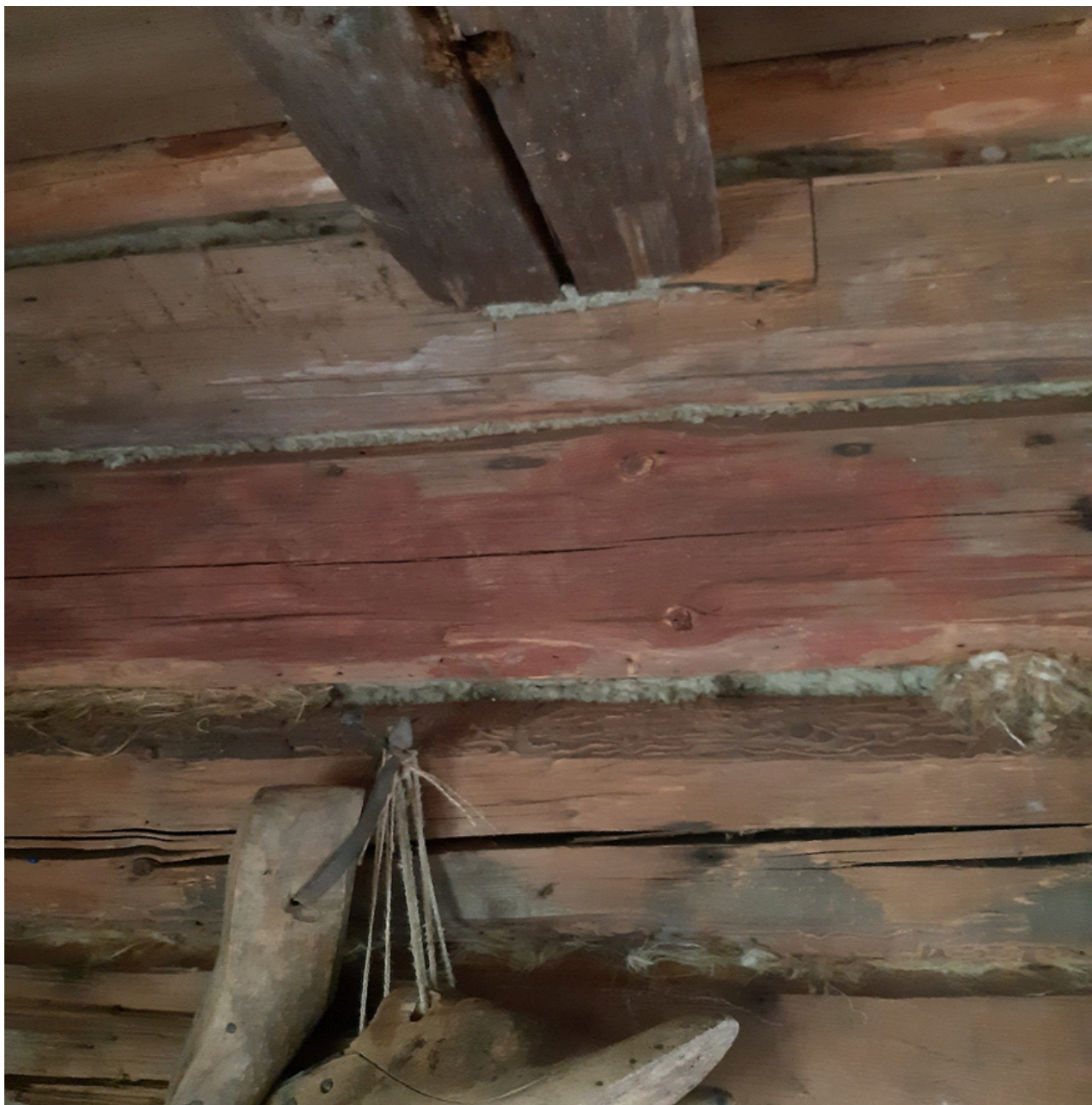
Eristys tehty väärällä villalla osittain. Pitäisi olla pellava rivettä.
