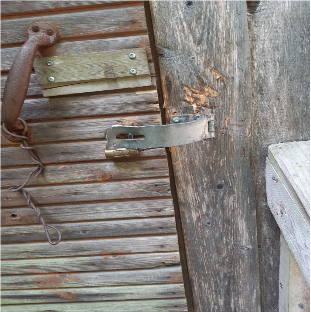
Oven lukko huonossa kunnossa. Voisi vaihtaa uudempaan.
