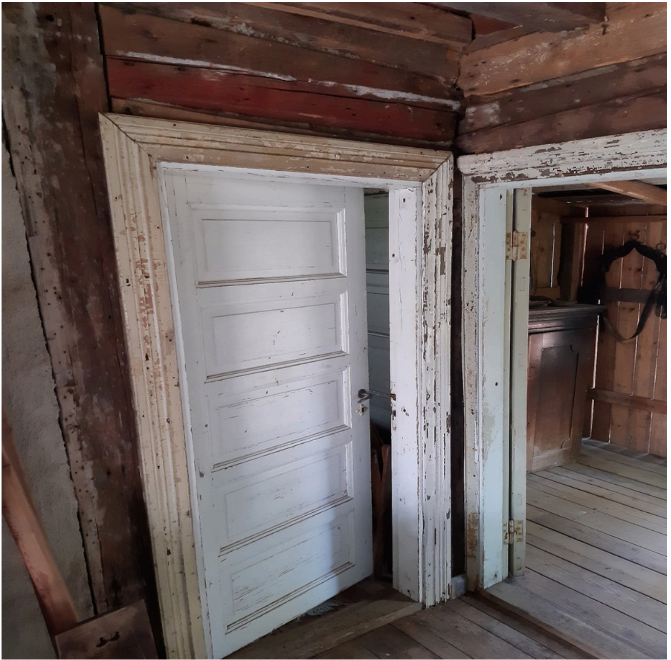
Ovien karmit ja laudoituksen huonossa kunnossa. Pitäisi maalata uudelleen.
