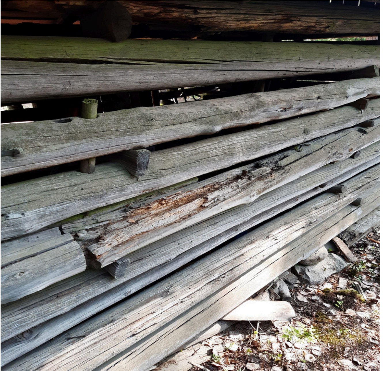
Hirsi lähtenyt paikoiltaan ja on lahona.
