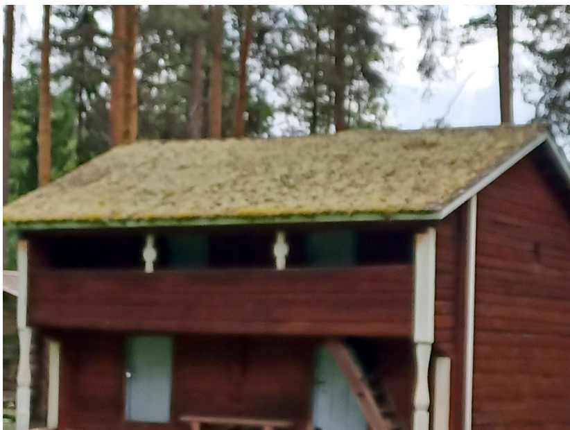
Kuva 19 Luhtiaitan katto oli sammaloitunut ennen kunnostusta ja oli paikoin vuotanut aitan toiseen kerrokseen.
