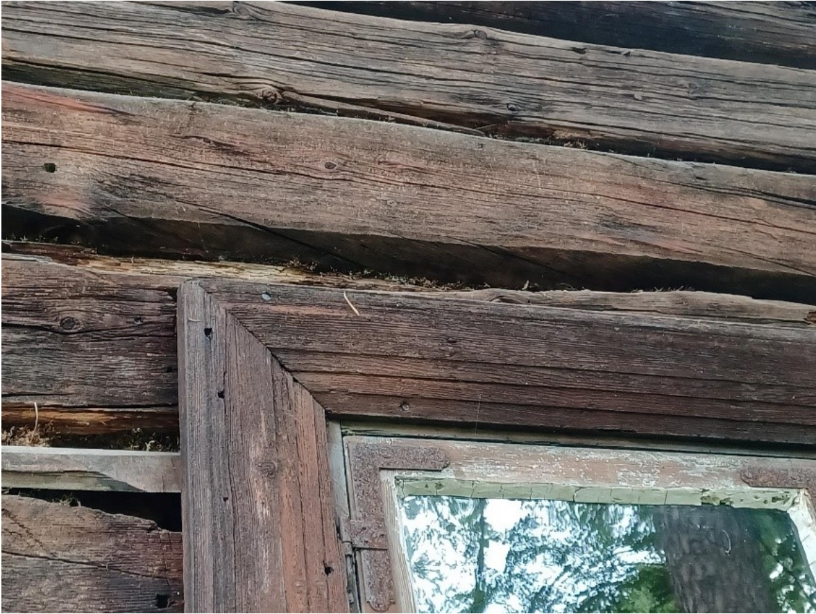
Kuva 16 Perinnerakennusmestari Ritva Ruponen suositteli, että Vänrikki Stoolin tuvan ulkoseinän hirsissä olevat isommat aukot harjattaisiin ja peitettäisiin, jotta ne eivät kerää kosteutta.
