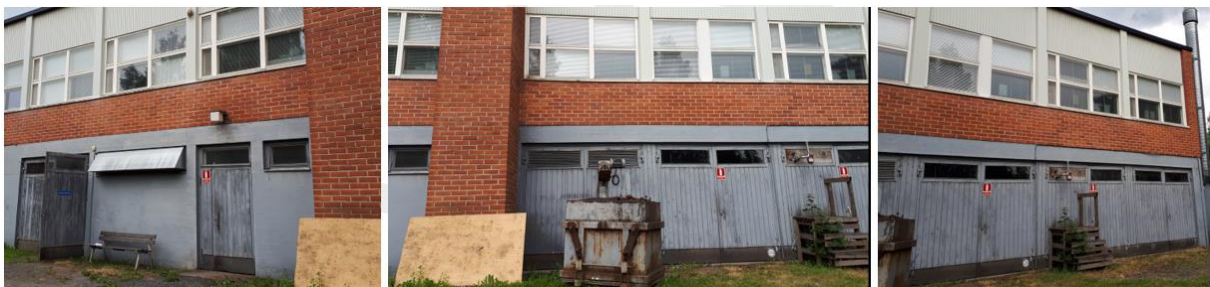
Kuva 8. Sivurakennuksen uusittavat ulko-ovet.
